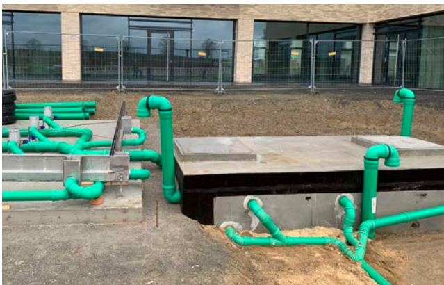
Zisterne zur Regenwassernutzung © Ramboll Studio Dreiseitl
